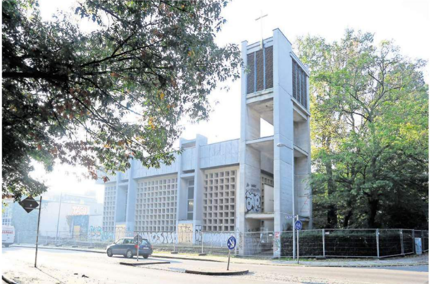
Der neue Eigentümer hat das Gelände der früheren Propsteikirche an der Emil-Fuchs-Straße einzäunen lassen. Zu seinen Plänen gibt er keine Auskunft. Von der Rechtslage her müsste er den Abriss nur noch vier Wochen vor Beginn bei der Stadt anzeigen. Foto: André Kempner
